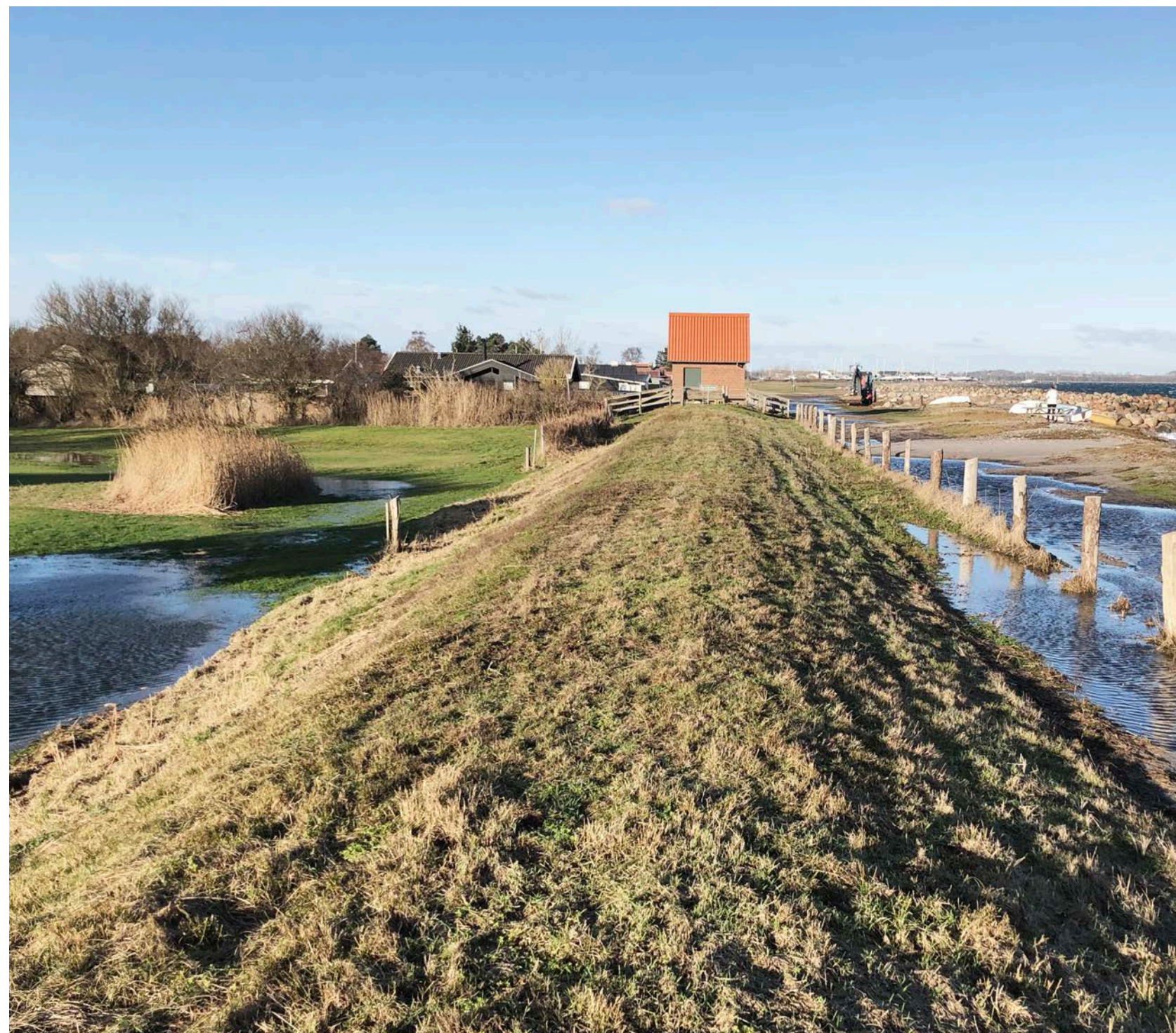
Juelsminde, ved diget: Problemer med grundvand efter en storm
