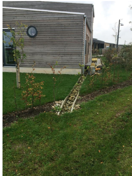
Regnvand ledes i en tæt rende fra bygningen til nedsivning i græsplænen. Foto Hedensted kommune
